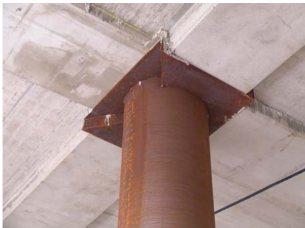
Figura 8. Intradosso capitello con fondelli di travi PREM
